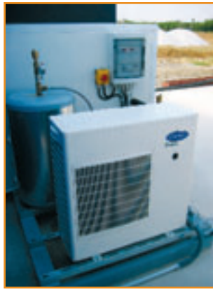
Groupe de climatisation réversible avec le ballon tampon eau + coffret électrique et interrupteur de sécurité
