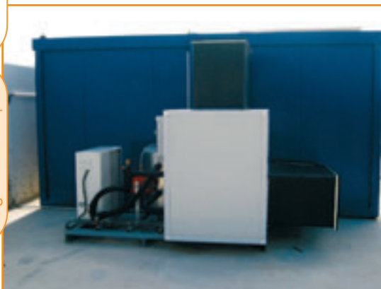
Vue d'ensemble du groupe de climatisation réversible avec les gaines de reprise et de diffusion
