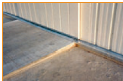
Etanchéité au sol par larmiers en tôle galvanisée (sur la périphérie du magasin)
