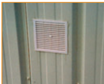
Ouïes d'aération pour ventilation statique
