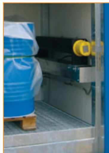
Détail : caisson + radiateur Atex pour maintien hors gel
