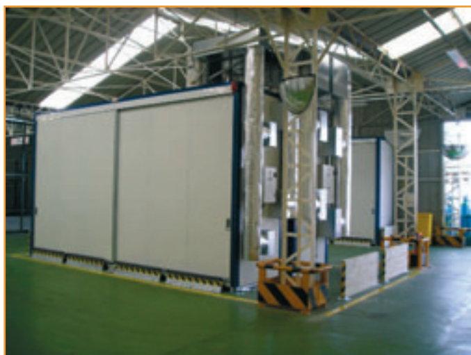
Armoires isolées climatisées installées sous hangar, avec protections frontales et latérales pour protection du matériel contre les engins de manutention
