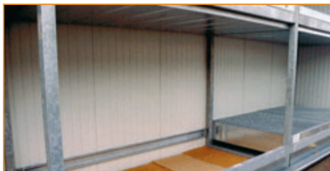
Complément d'isolation laine de roche sur armoires
