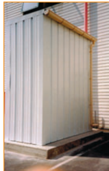
Gouttières et descente PVC
